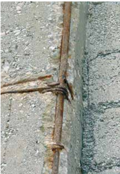
Degradación del recubrimiento de la armadura en un pilar de hormigón.
