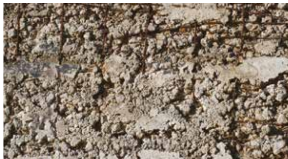
Ejemplo de segregación de los áridos en el hormigón.
