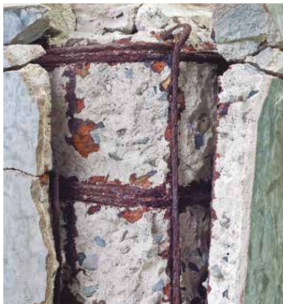
Expulsión del recubrimiento de la armadura a causa de la oxidación de las barras de armadura.
