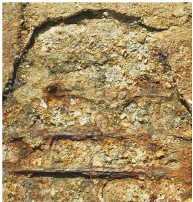
Ejemplo de corrosión debida al ataque de los cloruros.
