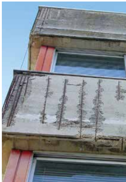
Hormigón con barras de armadura despojadas como resultado de la degradación.
