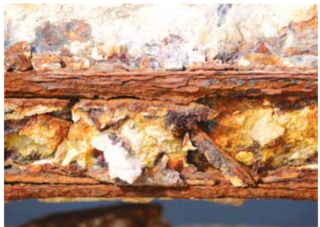
Ejemplo de degradación del hormigón por oxidación de las barras de armadura.
